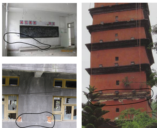
图1 正截面弯曲开裂形态地震实例
