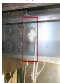
(a) 梁端腹板局部微小变形
