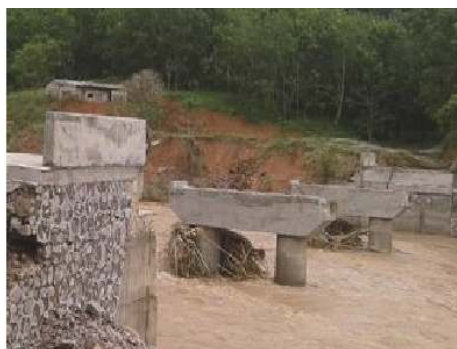
图1 洪水作用下桥梁上部结构失效
