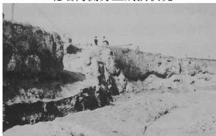
外墙局部坍塌状况
