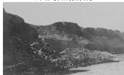
北墙内侧夯土残损状况
