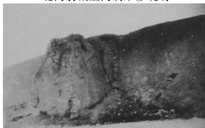
外墙马面残损状况
